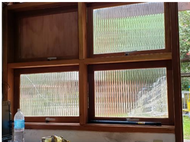
Figura 36: Antes da Manutenção das janelas.
